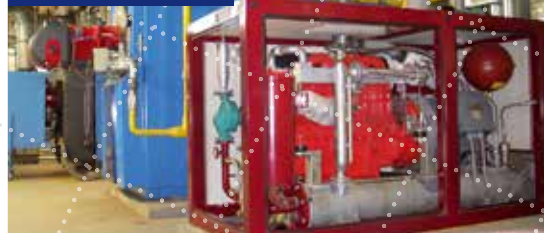
Heizzentrale mit BHKW
