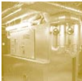
Solarstrom und Sanierung der Lüftungsanlage - zwei von zahlreichen Energieeinsparmaßnahmen in der Europaschule Köln.
